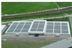
太陽光第二発電所
