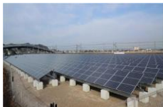
太陽光第一発電所
