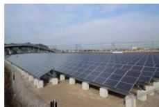
太陽光第一発電所
