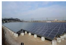
太陽光第一発電所
