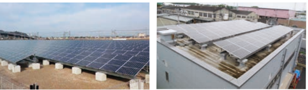
滋賀工場 第一発電所
